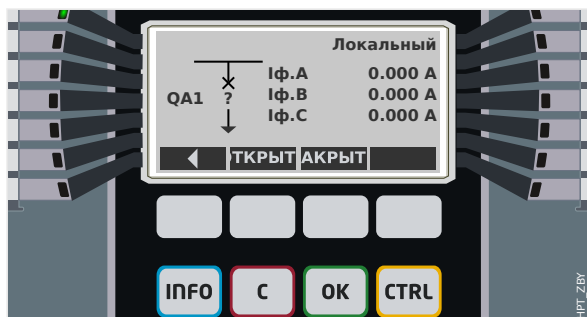
Рис. 4: Пример страницы управления, выключатель в аварийном (недопустимое состояние) положении.
